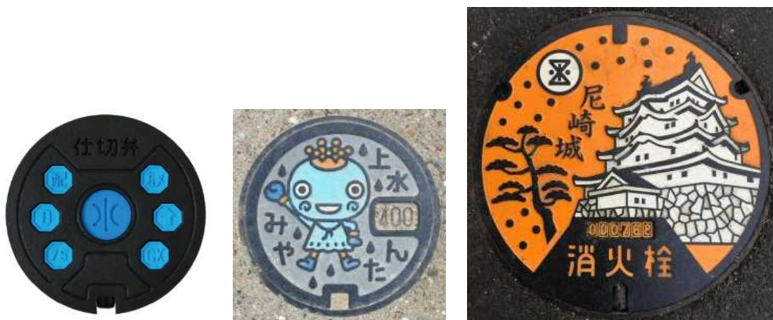
※ 管理Noキャップ設置状況（左：日之出水道機器(株) HP、中：西宮市上下水道局、右：尾崎市公営企業局）
