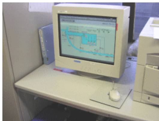
◇遠方監視装置1ヵ所（上下水道局1階）
