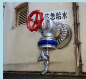
学校受水槽応急給水栓
