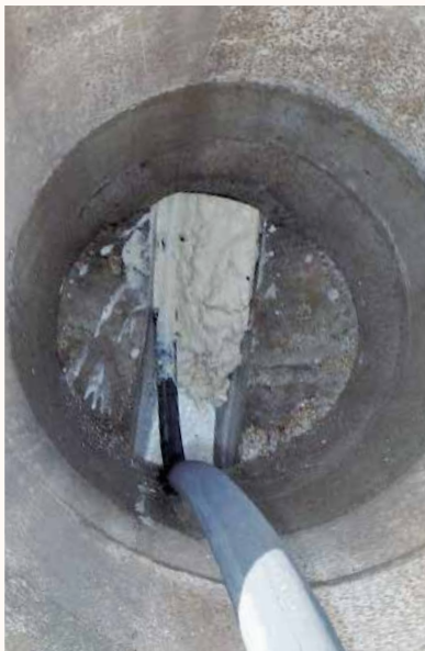
▲油脂により閉塞した下水道管
