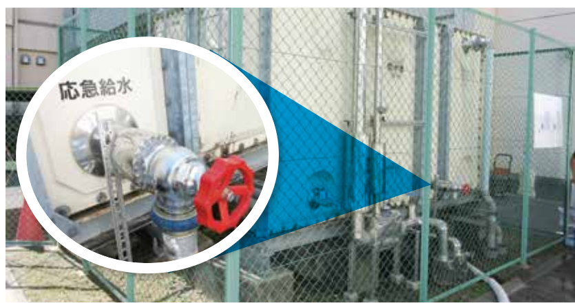
▲応急給水栓が設置された学校受水槽
