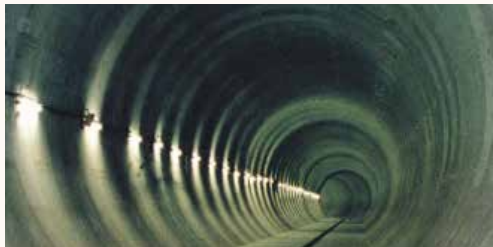
▲金岡雨水貯留管内部
