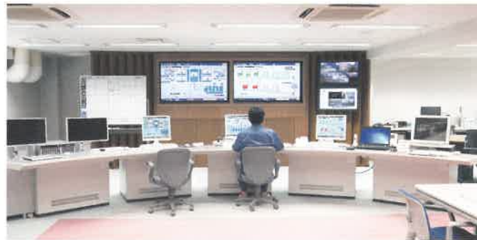
●中央かんし室/水道水をつくりつづけるため、24時間かんししています。
